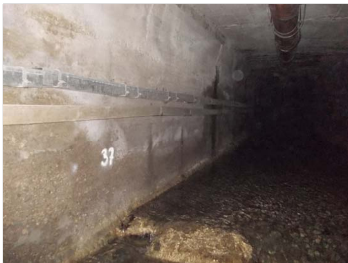
Foto 1 - Piedritto sx - canaletta laterale - salto di quota
