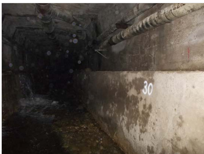
Foto 2 - Piedritto dx - canaletta laterale - ghiaia sul fondo
