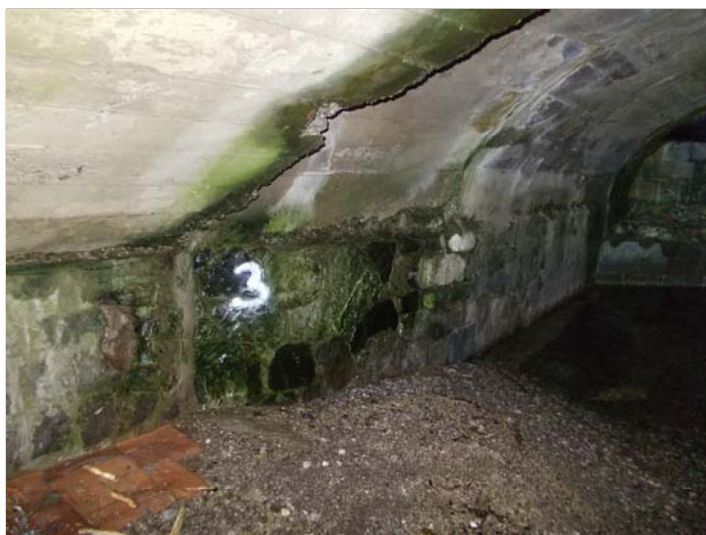
Foto 2 - Panoramica piedritto sx - ghiaia depositata
