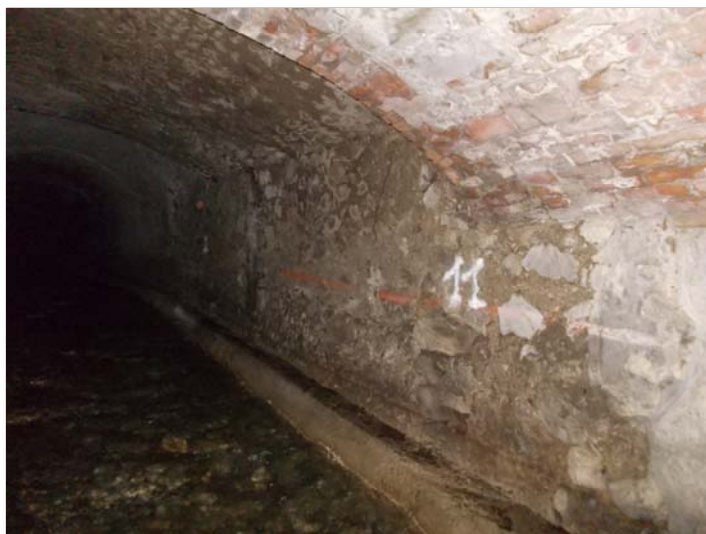
Foto 1 - Panoramica piedritto dx - ghiaia depositata sul fondo
