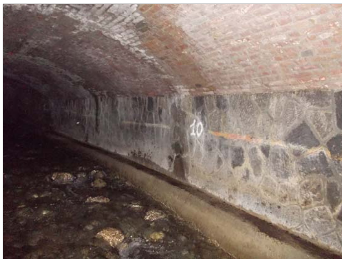
Foto 1 - Panoramica piedritto dx - ghiaia depositata sul fondo
