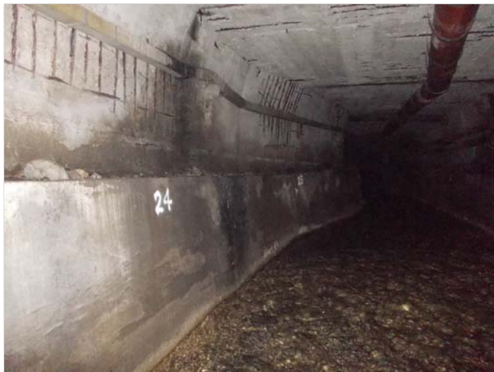
Foto 1 - Piedritto dx - canaletta laterale - ghiaia depositata
