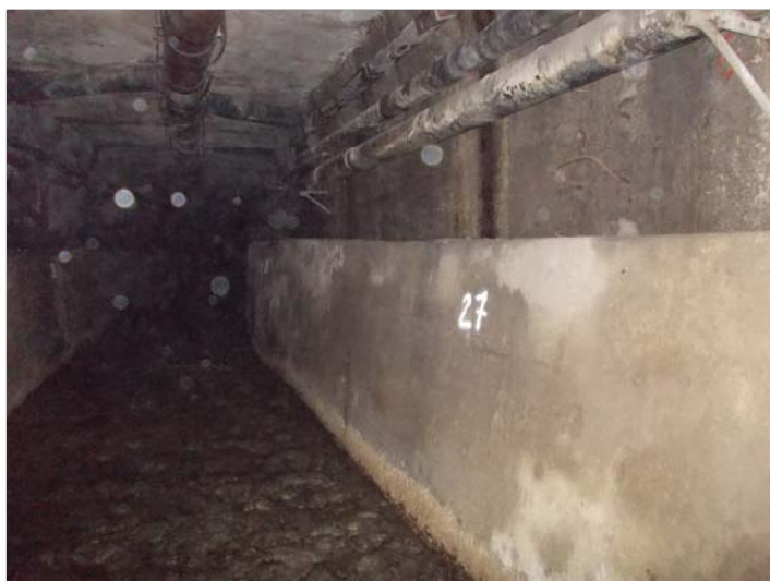
Foto 2 - Piedritto dx - canaletta laterale - ghiaia sul fondo
