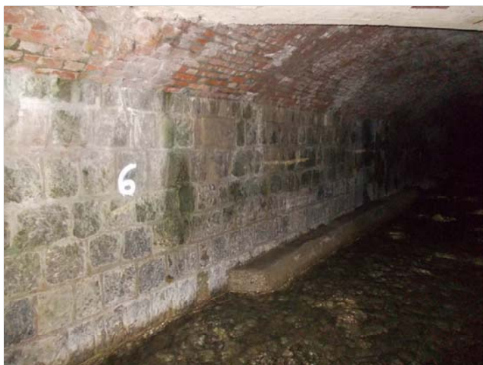
Foto 2 - Panoramica piedritto sx - ghiaia depositata
