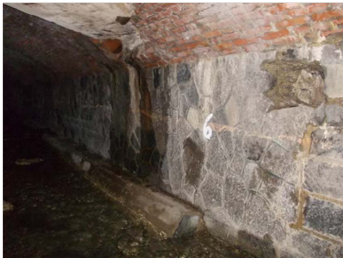
Foto 1 - Panoramica piedritto dx ghiaia depositata sul fondo
