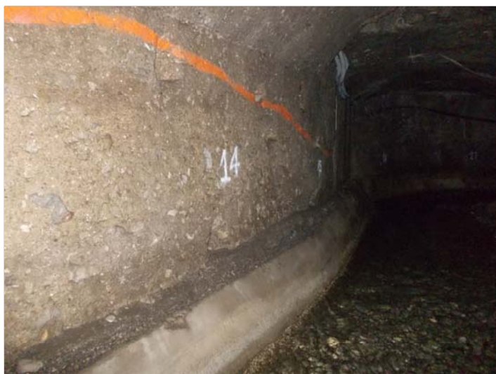
Foto 2 - Panoramica piedritto sx - ghiaia depositata
