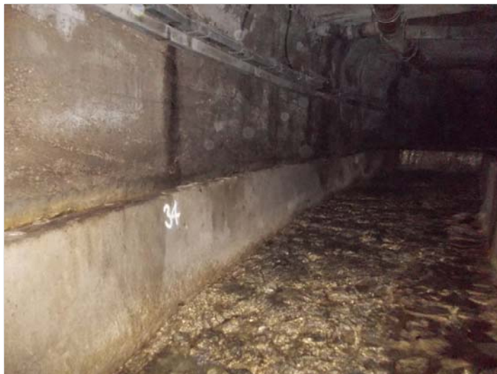
Foto 1 - Piedritto sx - canaletta laterale - ghiaia depositata sul fondo
