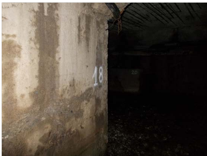
Foto 2 - Panoramica piedritto sx - infiltrazione dalla superficie
