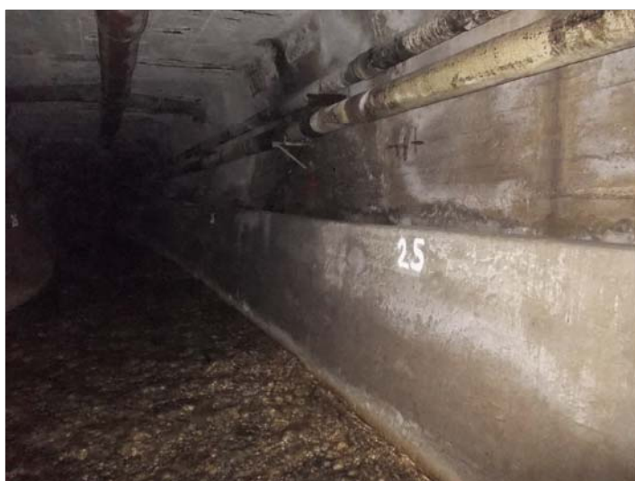
Foto 2 - Piedritto dx - canaletta laterale - ghiaia sul fondo
