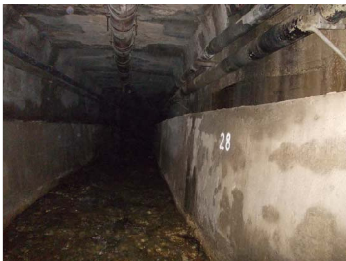
Foto 2 - Piedritto dx - canaletta laterale - ghiaia sul fondo
