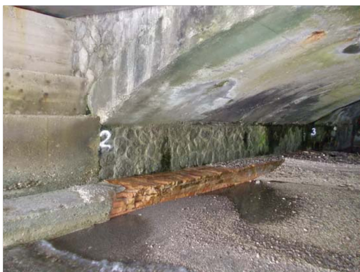
Foto 2 - Panoramica piedritto sx - ghiaia depositata
