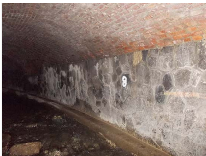
Foto 2 - Panoramica piedritto dx - ghiaia depositata
