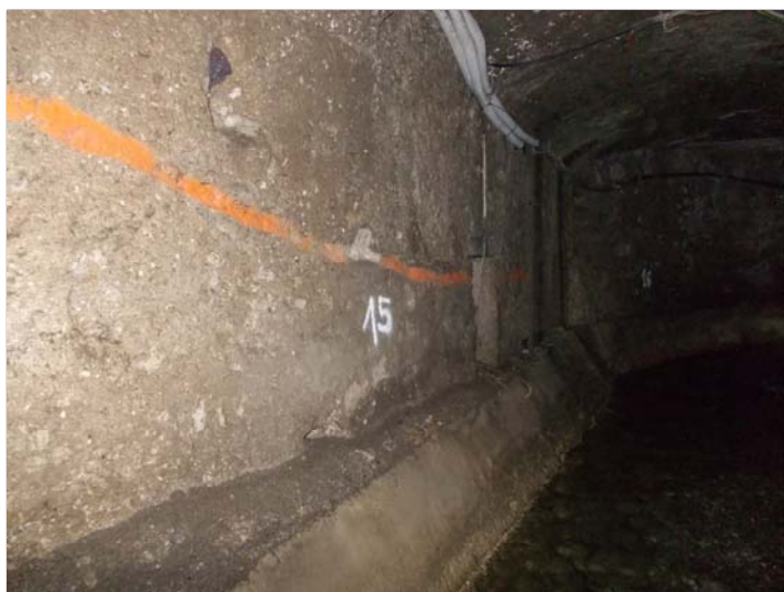
Foto 2 - Panoramica piedritto sx - ghiaia depositata
