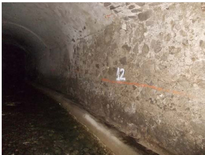
Foto 1 - Panoramica piedritto dx - ghiaia depositata sul fondo
