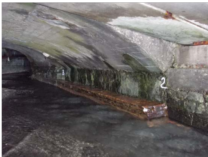
Foto 3 - Panoramica piedritto dx - ghiaia depositata
