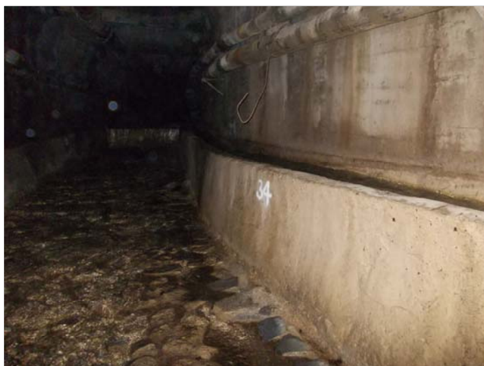
Foto 2 - Piedritto dx - canaletta laterale - ghiaia depositata sul fondo
