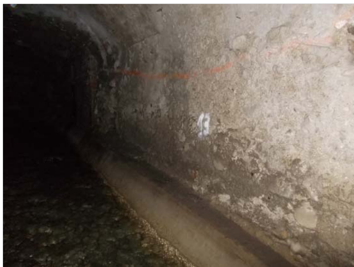
Foto 1 - Panoramica piedritto dx - ghiaia depositata sul fondo
