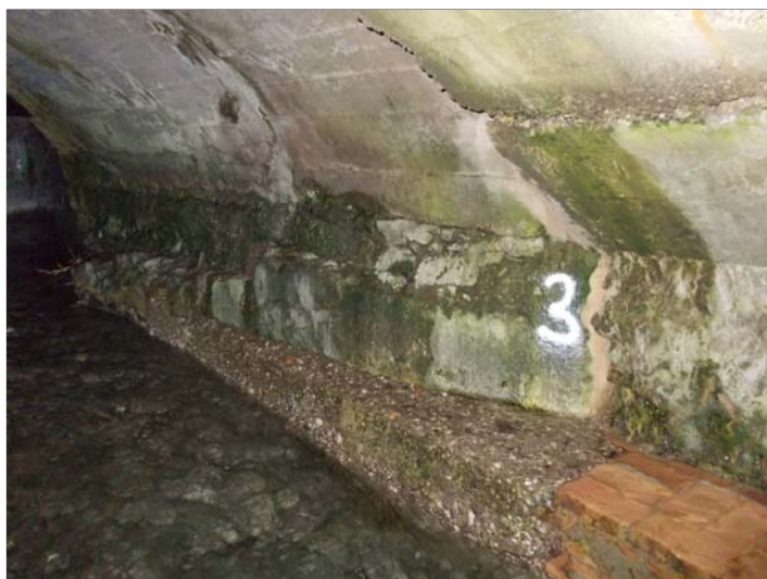
Foto 3 - Panoramica piedritto dx - ghiaia depositata
